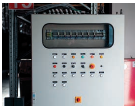
Рис. 5. Главный пульт управления передвижными стеллажами.
