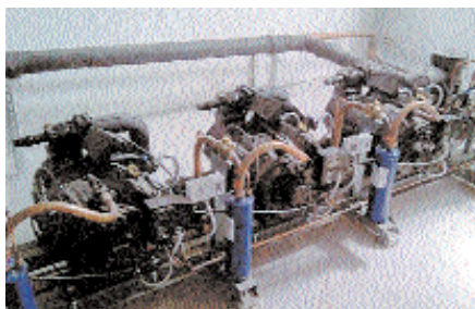
Рис. 4. Компрессорный агрегат для холодоснабжения камеры хранения фруктов
