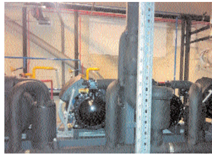
Рис. 3. Компрессоры Copeland Stream в машинном зале гипермаркета
