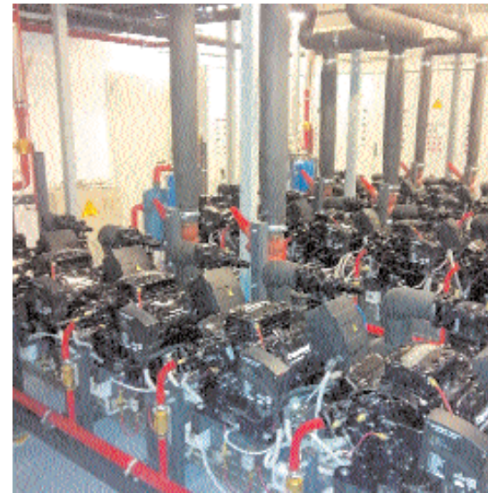
Рис. 4. Машинный зал — вид сверху
