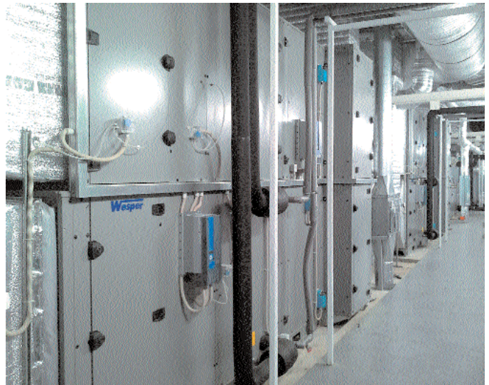
Рис. 4 Венткамера производственного корпуса
