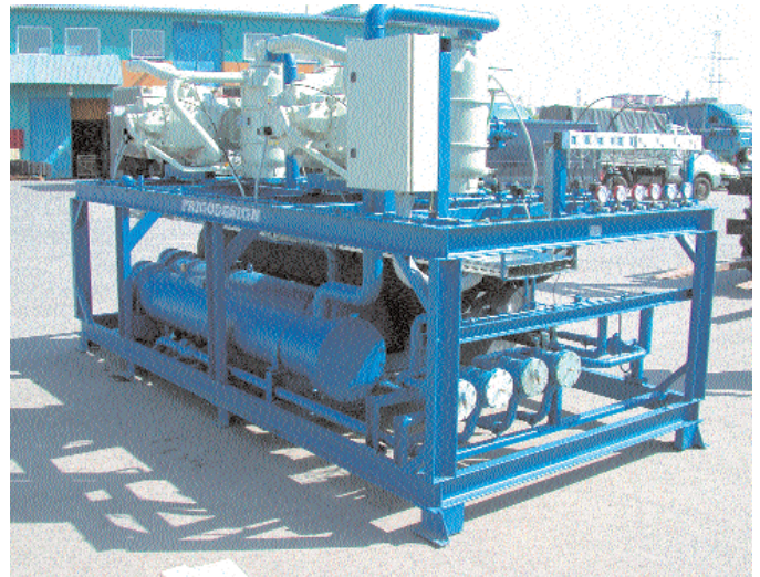
Генератор ледяной воды с кожухотрубным испарителем на молокозаводе в г.Каменск-Уральский
