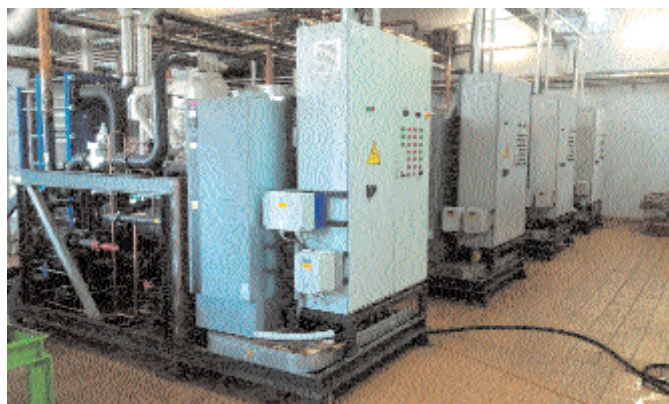
Генераторы ледяной воды Фригодизайн суммарной холодопроизводительностью 2,4 МВт на одном из крупнейших российских маслосыркомбинатов
