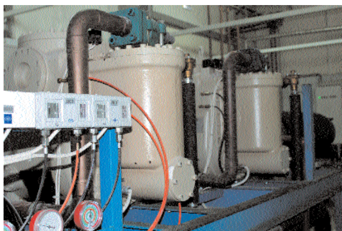
Генератор ледяной воды с кожухотрубным испарителем на Ивановском МЖК
