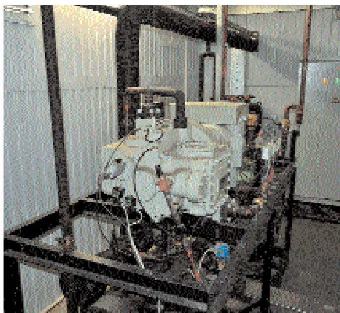
рис.7. Контейнерная компрессорная станция камеры глазировки креветок
