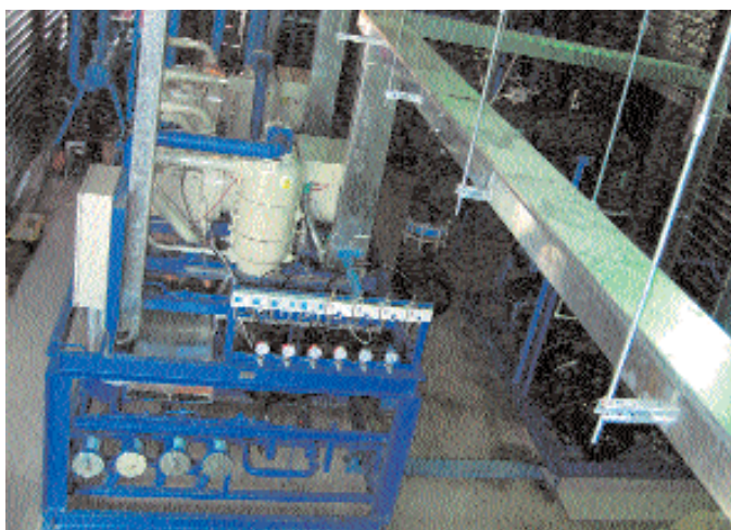
Генератор ледяной воды на кожухотрубном испарителе мощностью 1,1 МВт (Каменск-Уральский молокозавод)
