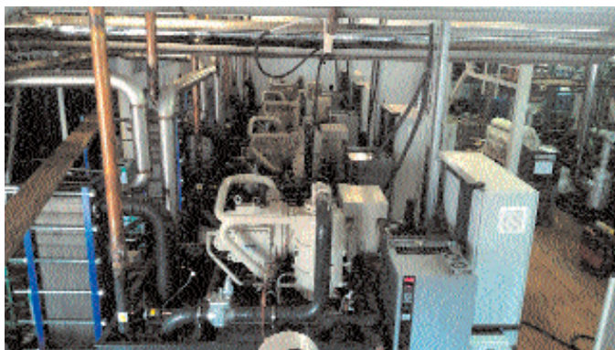
Четыре генератора ледяной воды общей холодопроизводительностью 2,4 МВт и расходом 300 м 3 /ч на Еланском сыродельном комбинате
