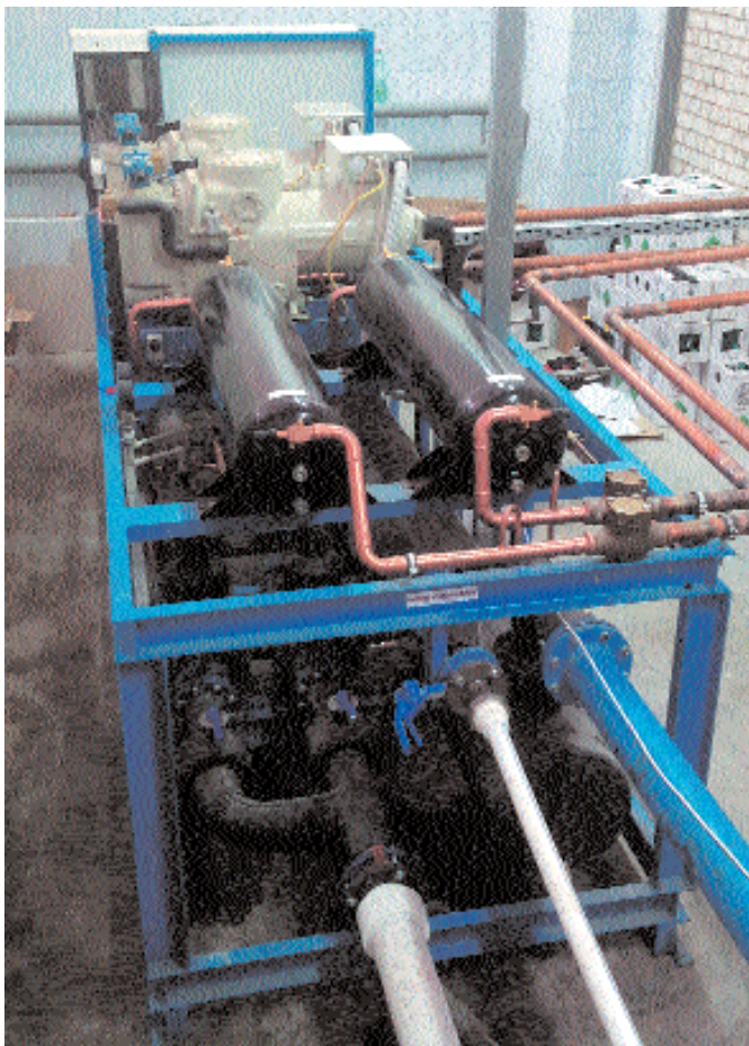
Генератор ледяной воды с кожухотрубным испарителем на Ивановском МЖК
