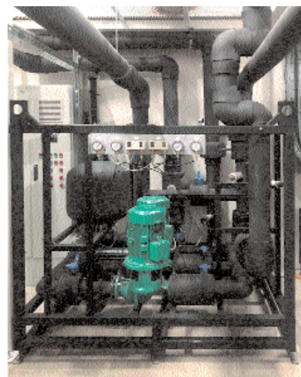
Рис. 5. Насосная станция хладоносителя для производственных помещений
