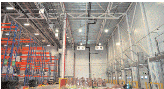
Крупнотоннажный холодильный склад с системой мониторинга
