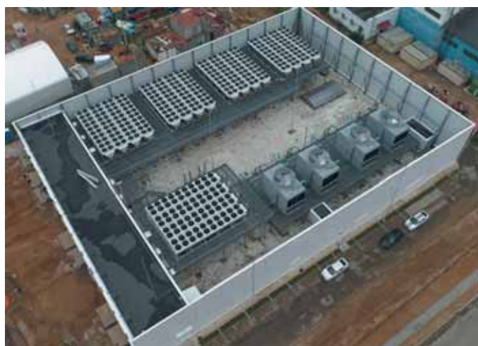
Центр холодоснабжения № 4 «Сколтех» (вид сверху)
