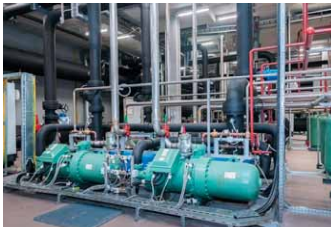
Центр холодоснабжения № 4 «Сколтех»
