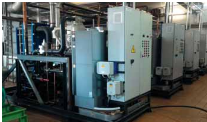
Еланский сыродельный комбинат. Четыре энергосберегающих генератора ледяной воды общей производительностью 2,4 МВт с частотными преобразователями привода компрессора при суммарном расходе воды 300 м 3 на пластинчатых теплообменниках
