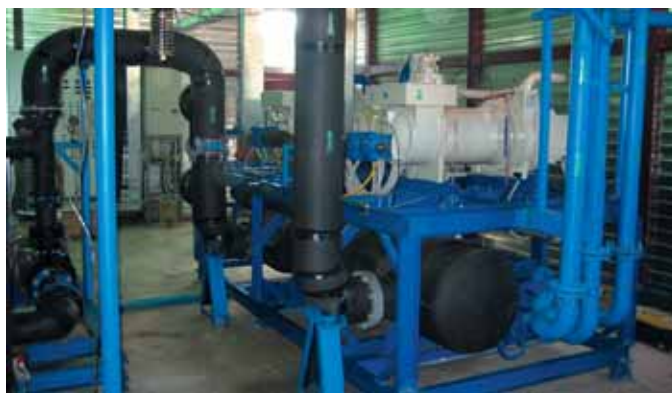
Каменск-Уральский молокозавод. Генератор ледяной воды на кожухотрубном испарителе производительностью 1,1 МВт с частотным преобразователем привода компрессора
