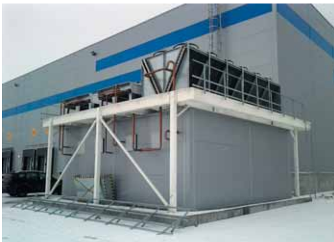
Машинное отделение системы холодоснабжения мультитемпературного склада с конденсаторами и драйкулером на крыше, изготовленное фирмой «Фриготрейд»
