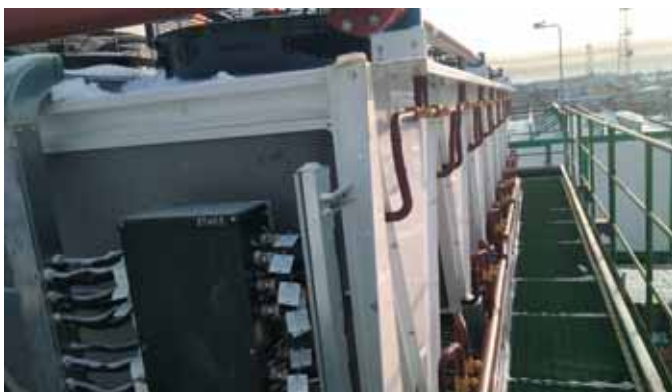
Воздушные конденсаторы на крыше сборно-разборного мобильного контейнера (температура окружающего воздуха в момент съемки -47^{\circ}\text{C} )
