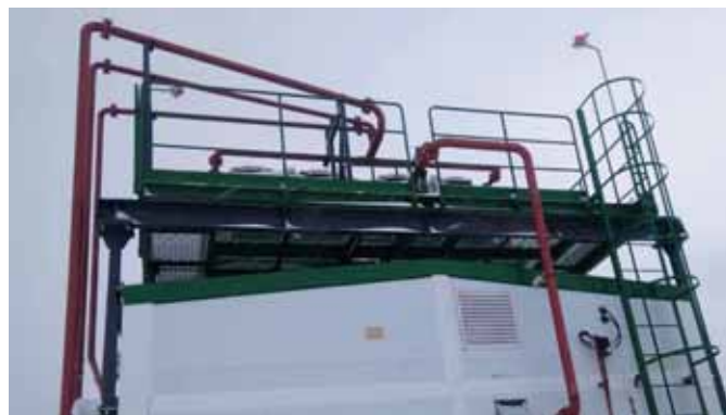
Нагнетательные трубопроводы системы холодоснабжения
