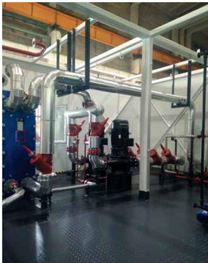
Пластинчатый испаритель и насосный агрегат внутри сборно-разборного мобильного контейнера
