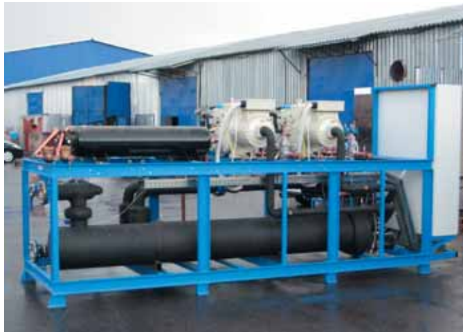
Установка ледяной воды на «Ивановском молочно-жировом комбинате»
