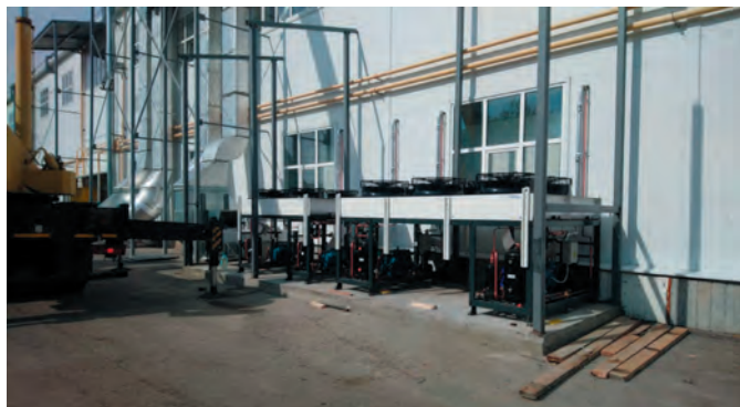
Холодильное оборудование испытательного климатического комплекса
