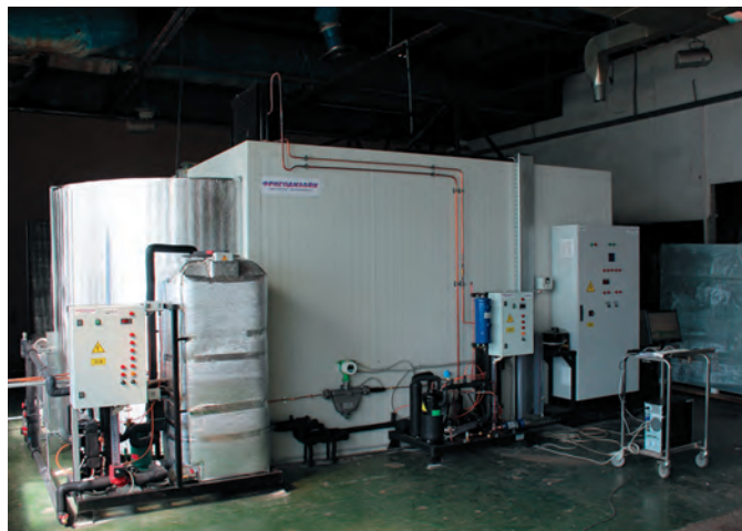
Холодильное оборудование климатической камеры
