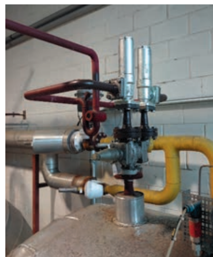
Установленные предохранительные клапаны с трубопроводами аварийного сброса хладагента
