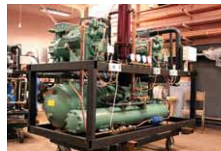
Две двухкаскадные холодильные установки для охлаждения хладоносителя до температуры -80^{\circ}\text{C} на химическом производстве в Красноярском крае
