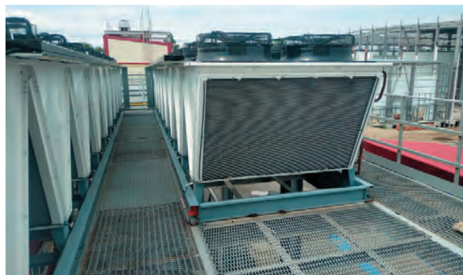
Воздушные конденсаторы с адиабатической системой увлажнения установлены на открытой площадке заказчика
