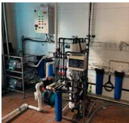
Установка водоподготовки и насосный агрегат для адиабатической системы охлаждения воздушных конденсаторов
