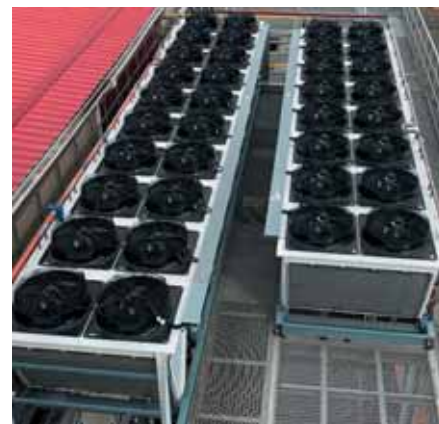
Конденсаторы холодильных установок
