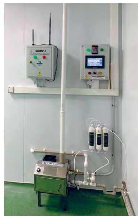
Шкаф управления с сенсорной панелью и ультразвуковой увлажнитель воздуха с фильтрами очистки воды
