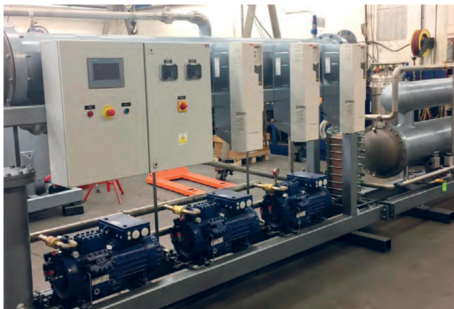
Углекислотная холодильная установка
