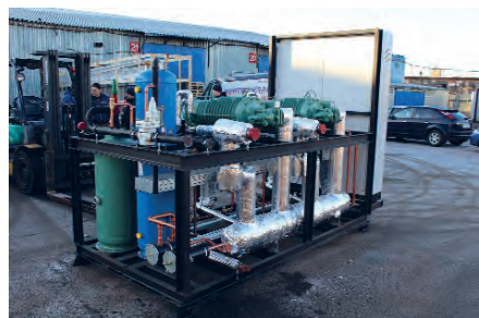
Установка охлаждения водного раствора этанола
