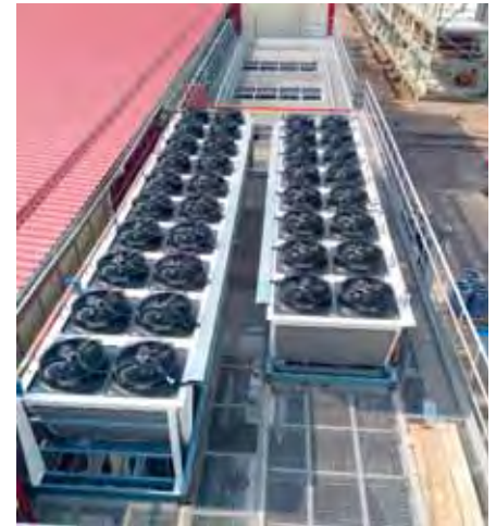
Воздушные конденсаторы с адиабатической системой охлаждения
