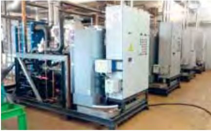
Генераторы ледяной воды общей холодопроизводительностью 2,4 МВт, установленные у заказчика
