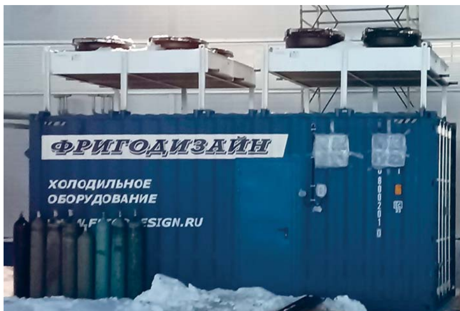
Контейнерная холодильная установка птицеперерабатывающего цеха
